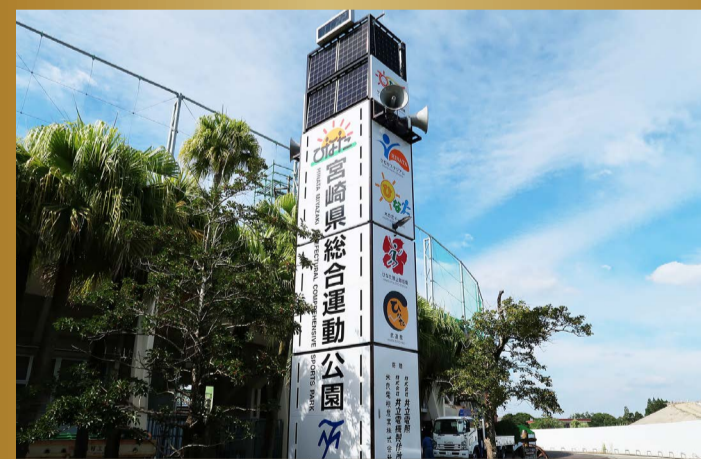
ひなたひむかスタジアム横に設置された照明灯
