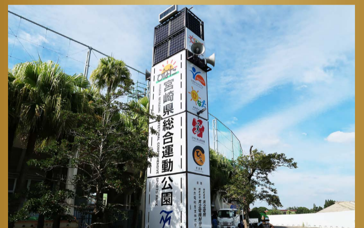
ひなたひむかスタジアム横に設置された照明灯
